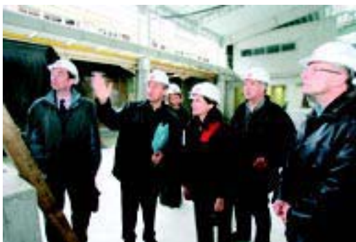
Jean-François Husson et Catherine Boulangé, l'architecte, font le point sur les travaux en compagnie de Serge Doudot, directeur du pôle « développement local » de la Ville, d'Alain Mangin, responsable du chantier au service du patrimoine et de René Schaller, co-président de l'association des producteurs, artisans et commerçants du marché.
